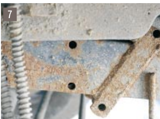
7 Rahmenrost: tückisch, gerade im vorderen Rahmenbereich.
